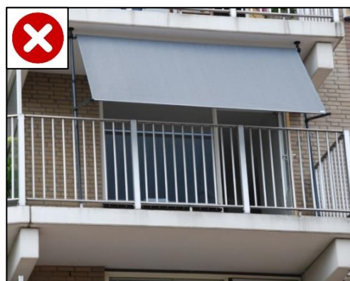
Couleur et pose inadaptées
