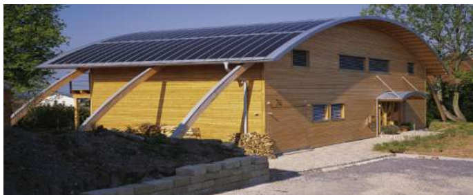
Module souple sur « bac zinc »
